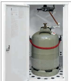
Einsicht in geöffneten Sockel mit angeschlossener Gasflasche
